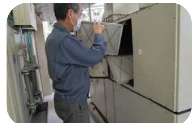
空調フィルターを交換し、清潔な空気を保てるようこころがけています。
