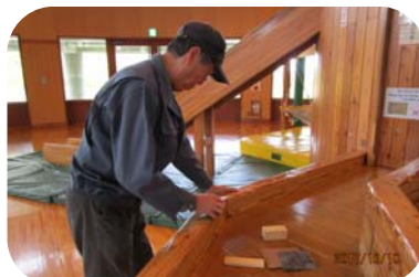
木のささくれなど研磨（ヤスリで削る）や塗装をしています。
